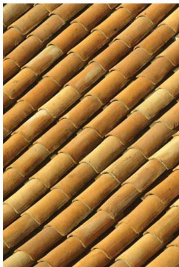
Detalle del tejado de los aleros que circundan el patio interior del edificio del Ministerio de Relaciones Exteriores.
